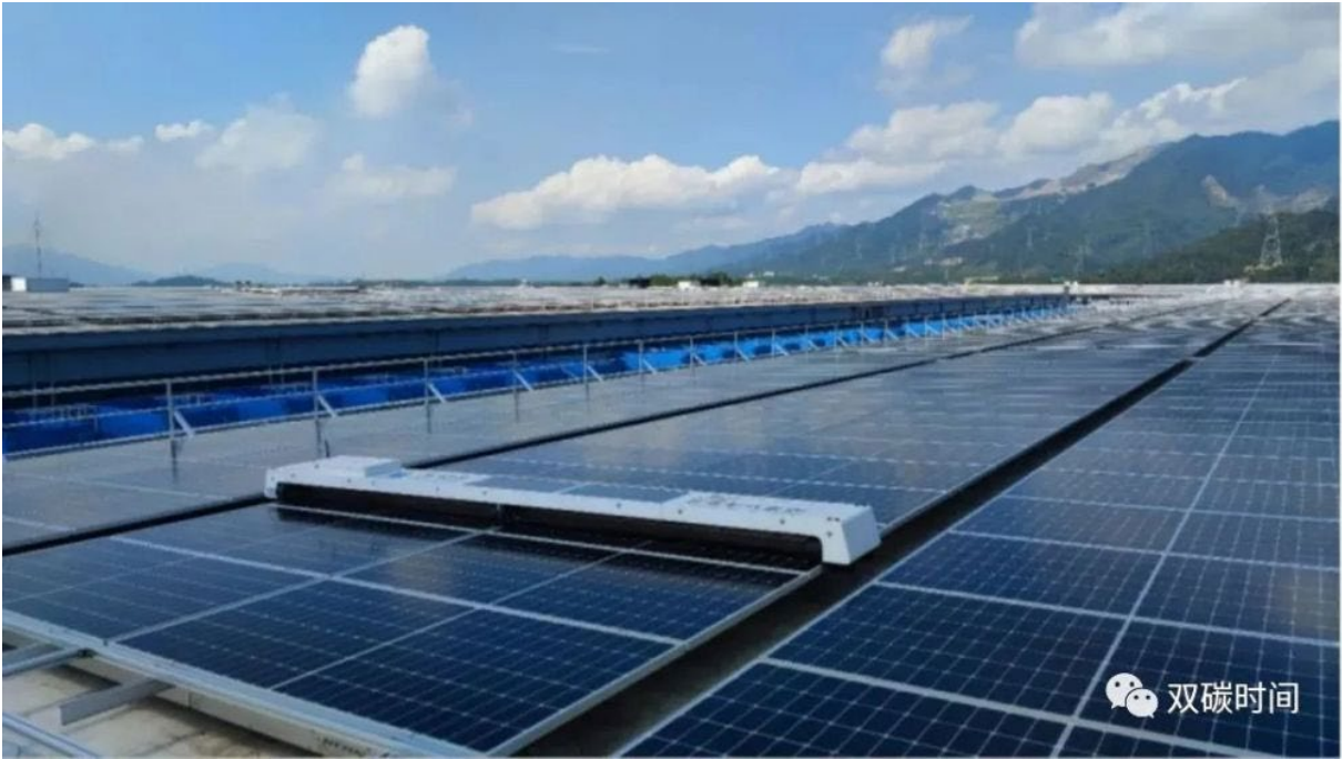
사진 2) 출처: 텡쉰왕(腾讯网). 스마트에너지생태플랫폼 지붕의 태양광 패널
