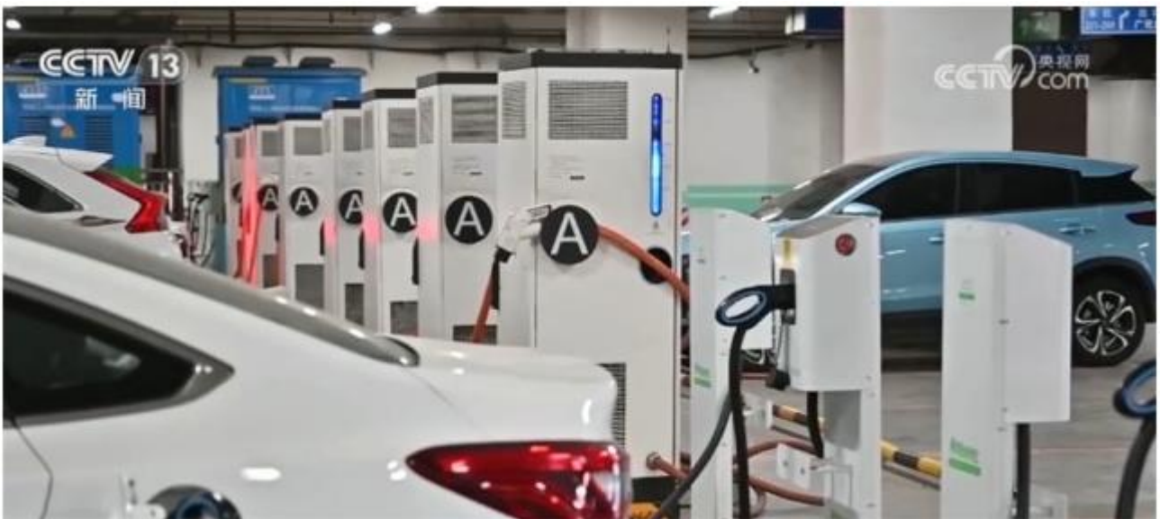
사진 1) 아파트 주차장 내 충전 시설(CCTV)
